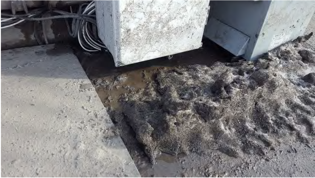
Figure 6.4-18 : Accumulations d'eau de fonte qui ne ruisselle pas vers les drains
