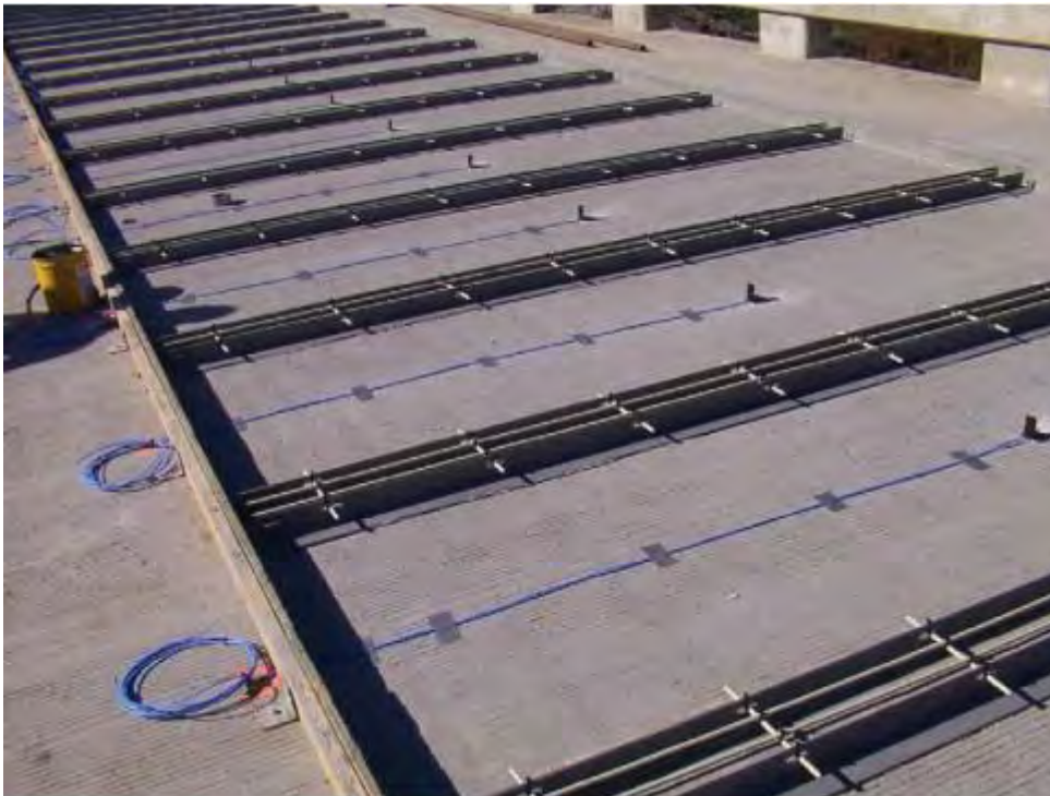
Figure 6.1-6 : Électrodes qui dépasse de la dalle structurale du pont Roca Spur, Nebraska
