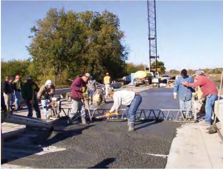
Figure 6.1-7 : Coulée du béton conducteur en surépaisseur à la dalle structural du pont Roca Spur, Nebraska
