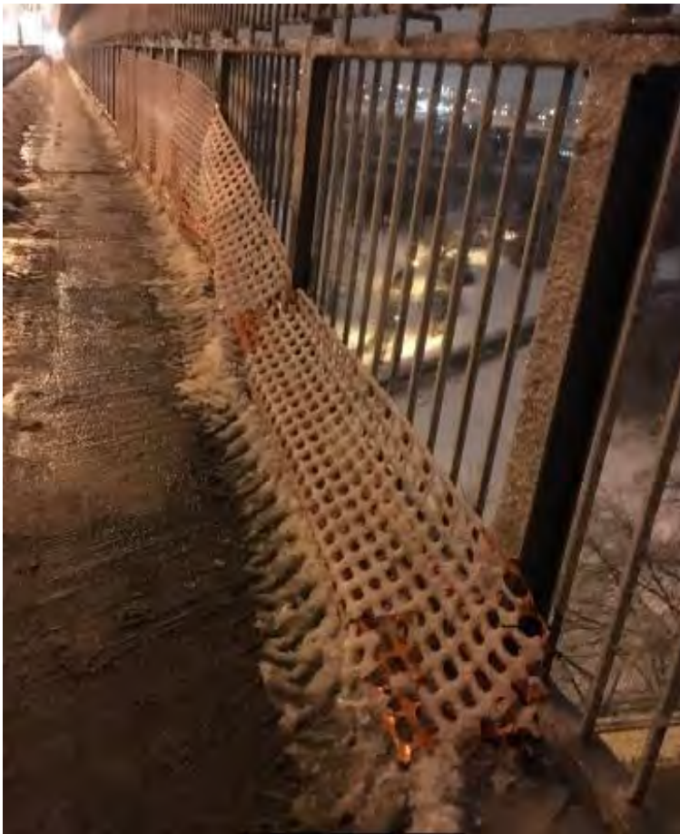
Figure 3.7-15 : Clôture à neige installée par-dessus des voies routières, suite à la tempête de verglas du 23 janvier 2018.
