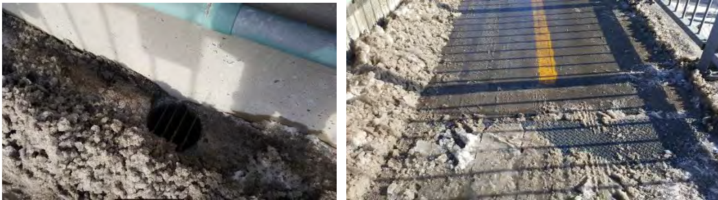
Figure 3.6-7 : drains confinés par la neige accotée a la glissière de sécurité (à gauche) ; plaque couvre-joint glacé et ses approches enneigées (à droite)
