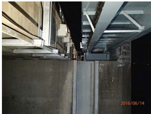
Figure 2 - Structure de l'Estacade en béton précontraint et structure de la piste cyclable en acier
