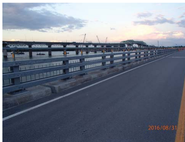
Figure 1 - Nouveaux dispositifs de retenue depuis 2012-2013
