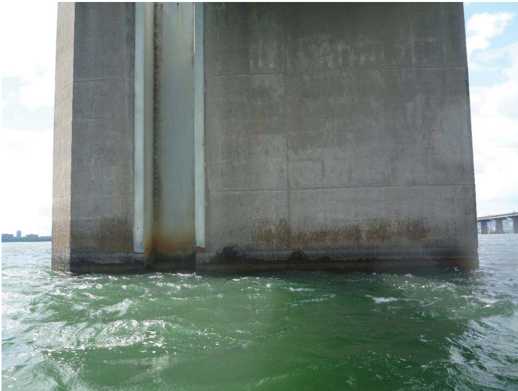
Figure 329 : Paroi droite / Pile 61 (ES61-PD)
