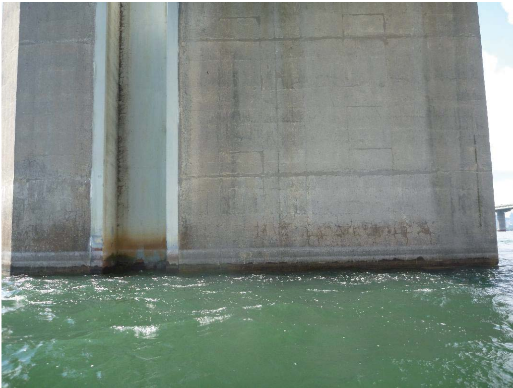
Figure 373 : Paroi droite / Pile 72 (ES72-PD)
