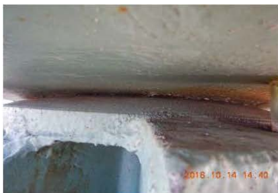
Photo 1: Surfaces sphériques JC_6_161014_EM_1078
