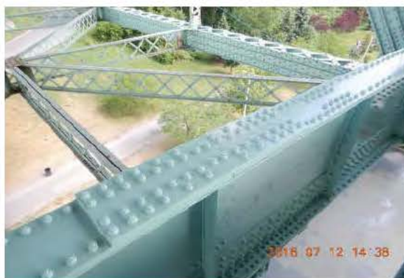
Photo 1: Poutre levage L10
