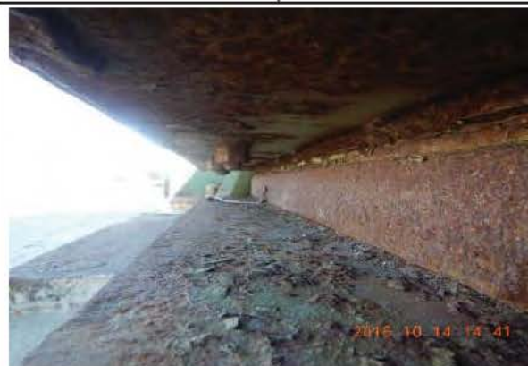
Photo 2: Surfaces inférieures JC_6_161014_EM_1081
