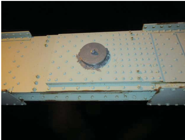
Tourillon 12T Ferme Amont – Tige filetée Côté Brossard (Joint 0.5E) - après peinture
