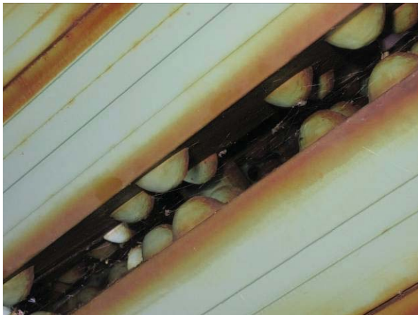
Tourillon 12N Ferme Centrale – Tige filetée Côté Montréal (Joint 0.5W)
