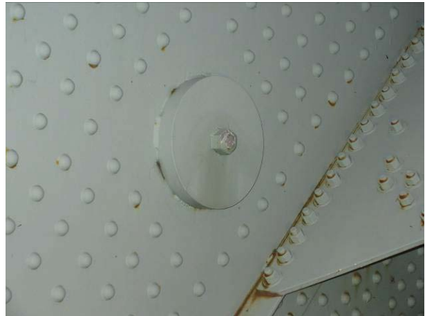
Tourillon 12K Ferme Amont Côté Brossard (Joint 0.5E)
