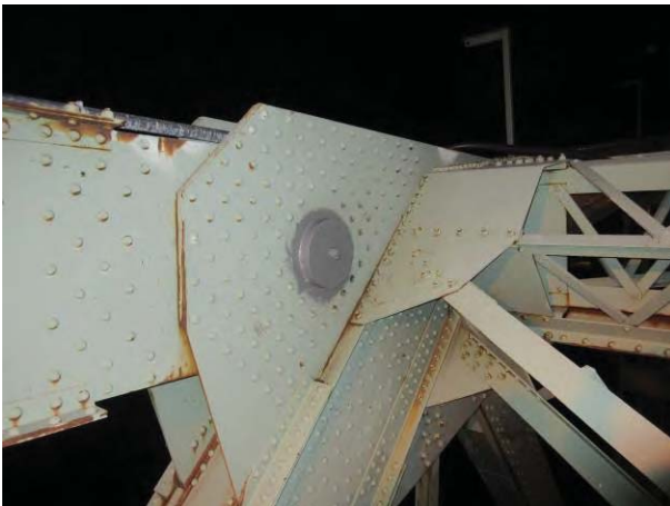
Tourillon 12K Ferme Aval Côté Montréal (Joint 0.5W) - après peinture
