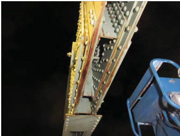
Tourillon 12T Ferme Aval – Tige filetée Côté Brossard (Joint 0.5E)
