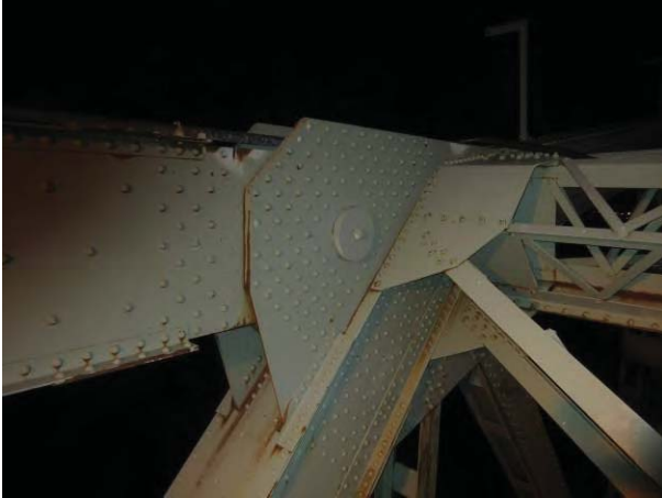
Tourillon 12K Ferme Aval Côté Montréal (Joint 0.5W)
