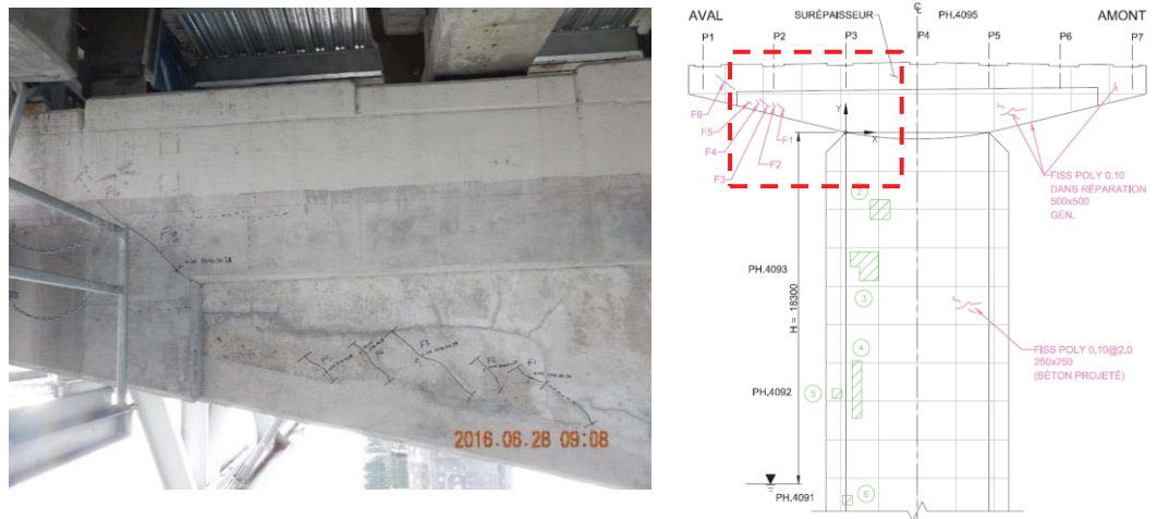
Figure 8 Signes de détérioration observés sur les chevêtres (présentée)
